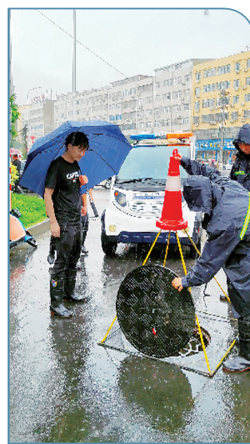
7月16日,郸城县城管局工作人员正在排查下水道排水情况。 记者 徐松摄
